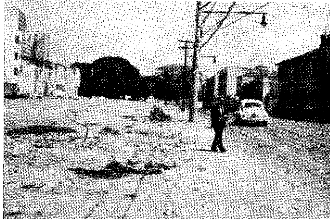
Foto 4 — Trecho da Rua Vergueiro já preparado para alargamento, graças à demolição das edificações de um dos lados.
