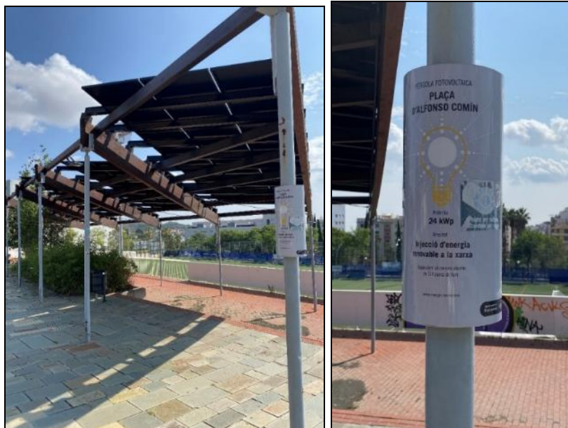
Figura 9 – Pergolado com placas solares na Plaza Alfons Comín, em Barcelona Fonte: os autores (2024)
