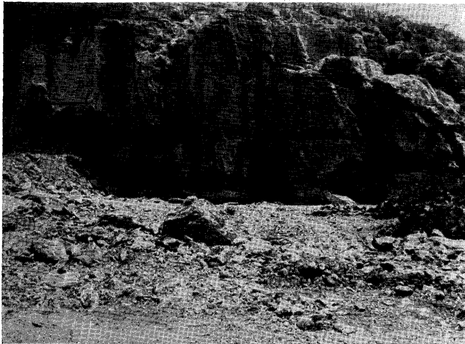
Foto 13 — “Lapiez” limpos na pedreira Cauê, Pedro Leopoldo (M G) . Notar as cavidades subterrâneas calcadas sôbre as juntas na parte inferior da frente de talha da pedreira
