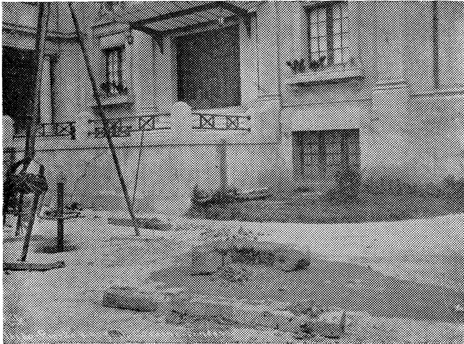
Fig. 9 — Sondagens feitas no terreno onde foi construído o Teatro Cassino, a qual revelou grande quantidade de vaza a pequena profundidade. Vê-se no edifício uma fenda similar às inúmeras que existiam no interior do prédio.
