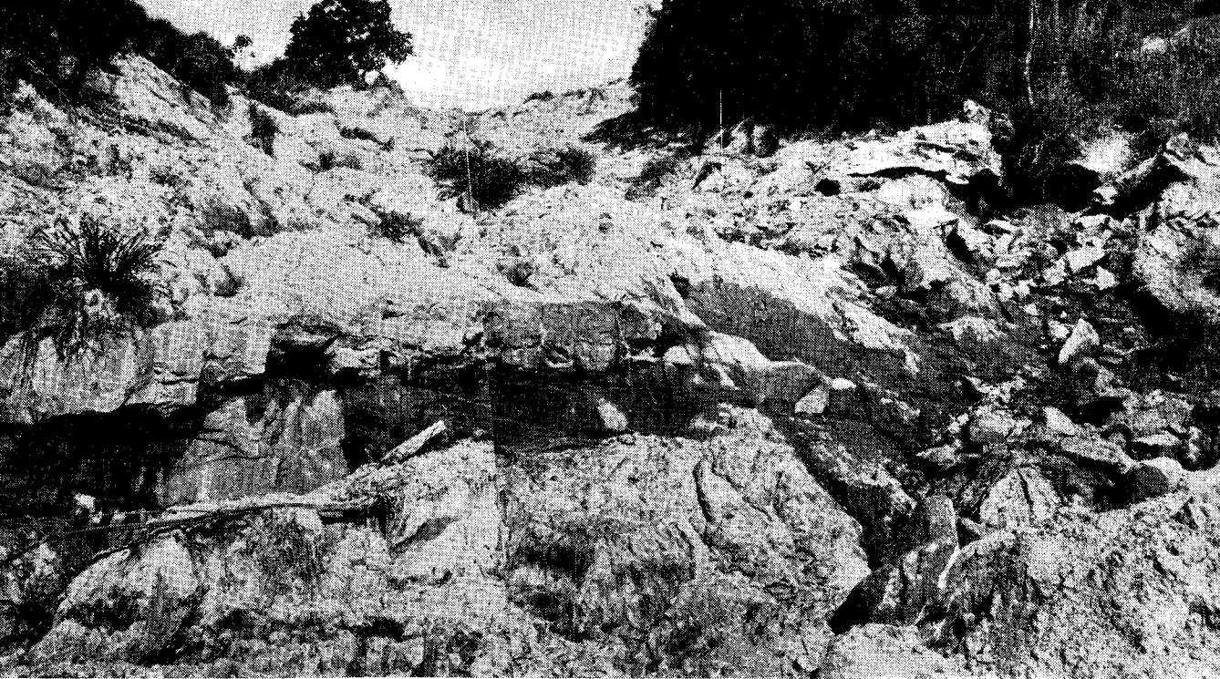
Fig. 11 — Rua Belisário Távora: detalhe da estrutura, mostrando afloramento de lajes limitadas por diáclases curvas e cortadas por diáclases retilíneas dentro da cicatriz.
