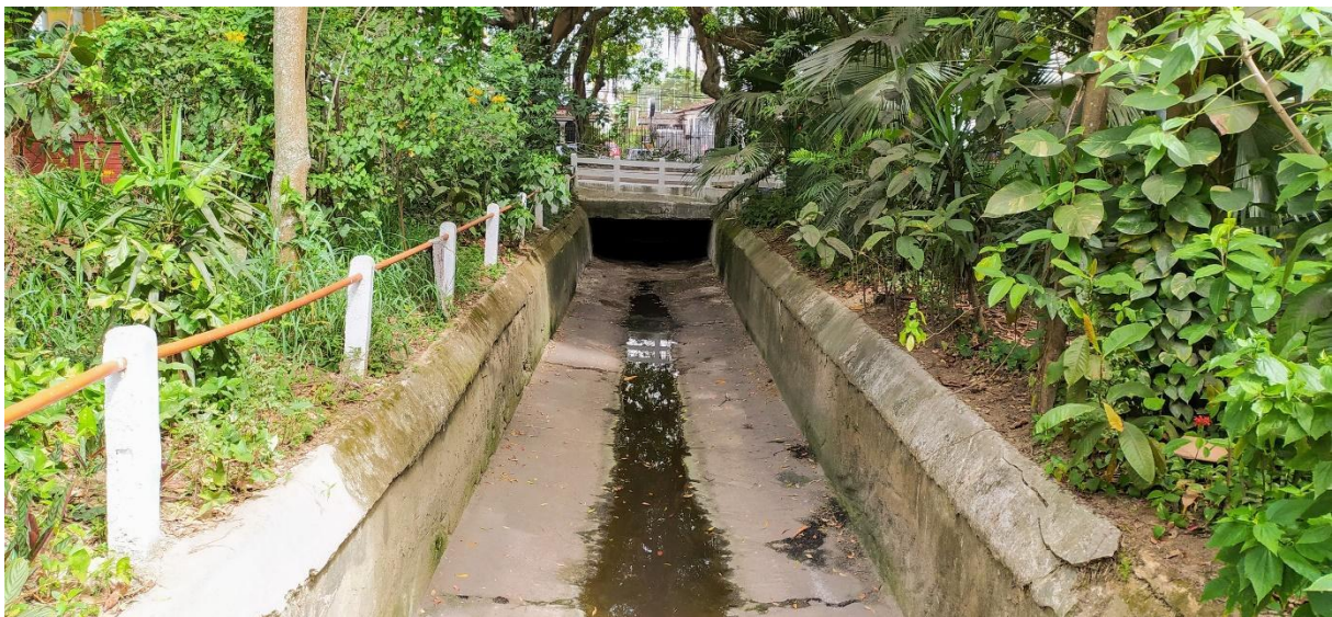
Figura 5. Rio Icaraí, localizado na cidade de Niterói (RJ), no trecho em que atravessa a área verde do Campo de São Bento. A intervenção promovida pela prefeitura resultou na redução do fluxo de água em um trecho já canalizado e concretado em suas margens e leito. Foto: André Pelech (dezembro de 2019).
