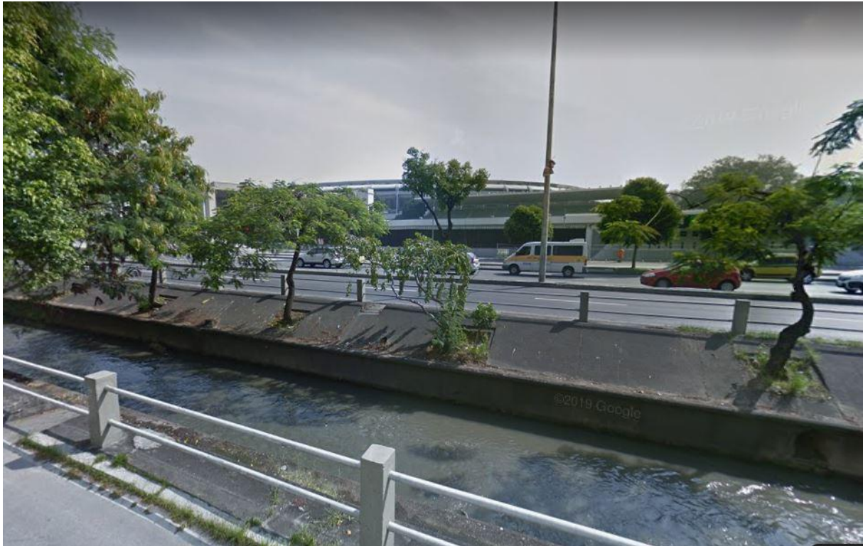
Figura 3. Rio Maracanã, localizado na cidade do Rio de Janeiro. Observa-se a canalização do rio, que está confinado por margens antropogênicas e recebe uma grande carga de esgoto sem tratamento e resíduos sólidos, com vias de grande fluxo instaladas na sua planície. Ao fundo, o estádio de futebol homônimo. Fonte: Google Maps (maio de 2017).
