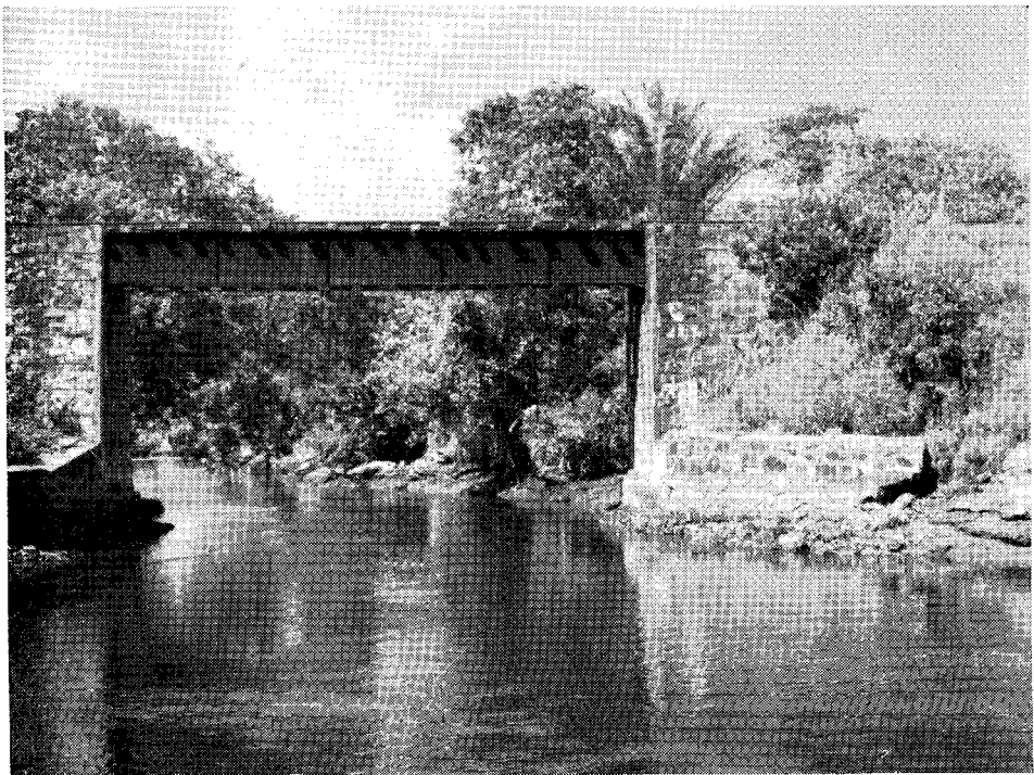
Fig. 20 — Trecho do canal do Itaípe, que liga o rio Almada ao Cachoeira. Aberto pelos jesuítas, desempenhou grande papel quando do estabelecimento da cultura cacauceira no vale do Almada. A ligação dos dois rios possibilitava o escoamento da produção para o porto de Ilhéus. A estrada de ferro, construída no início do século, seguiu o vale, eliminou a via fluvial no transporte do cacau.
